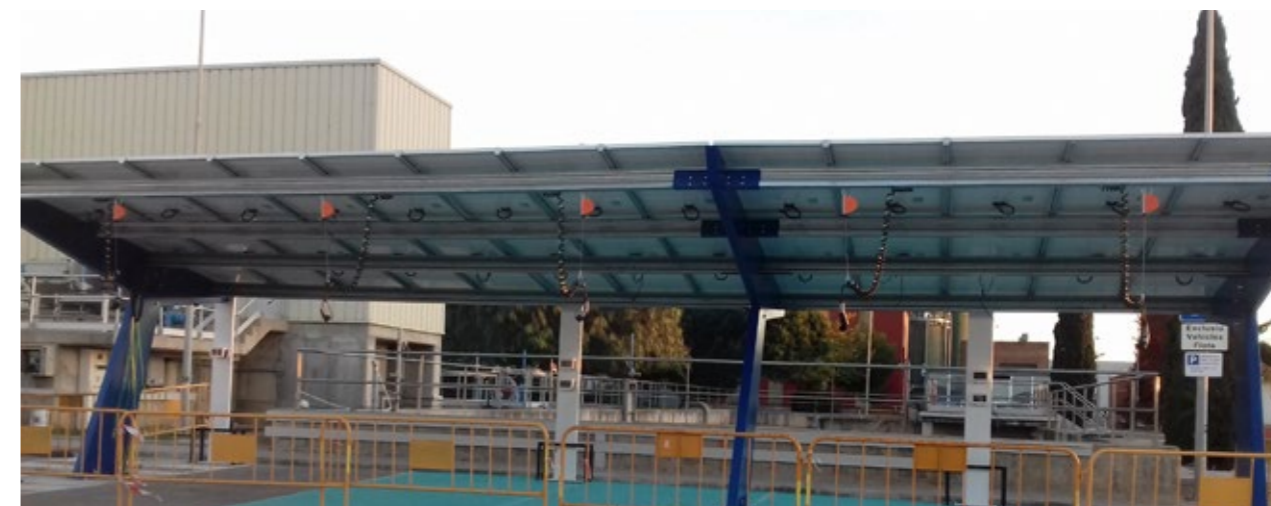
Pèrgola de captació fotovoltaica a l'ETAP Sant Joan Despi.
